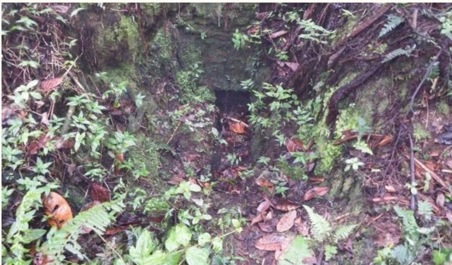
Figura 9. Ducto de ventilación y/o drenaje en una de las colcas de estilo inca en Paxamarca.
